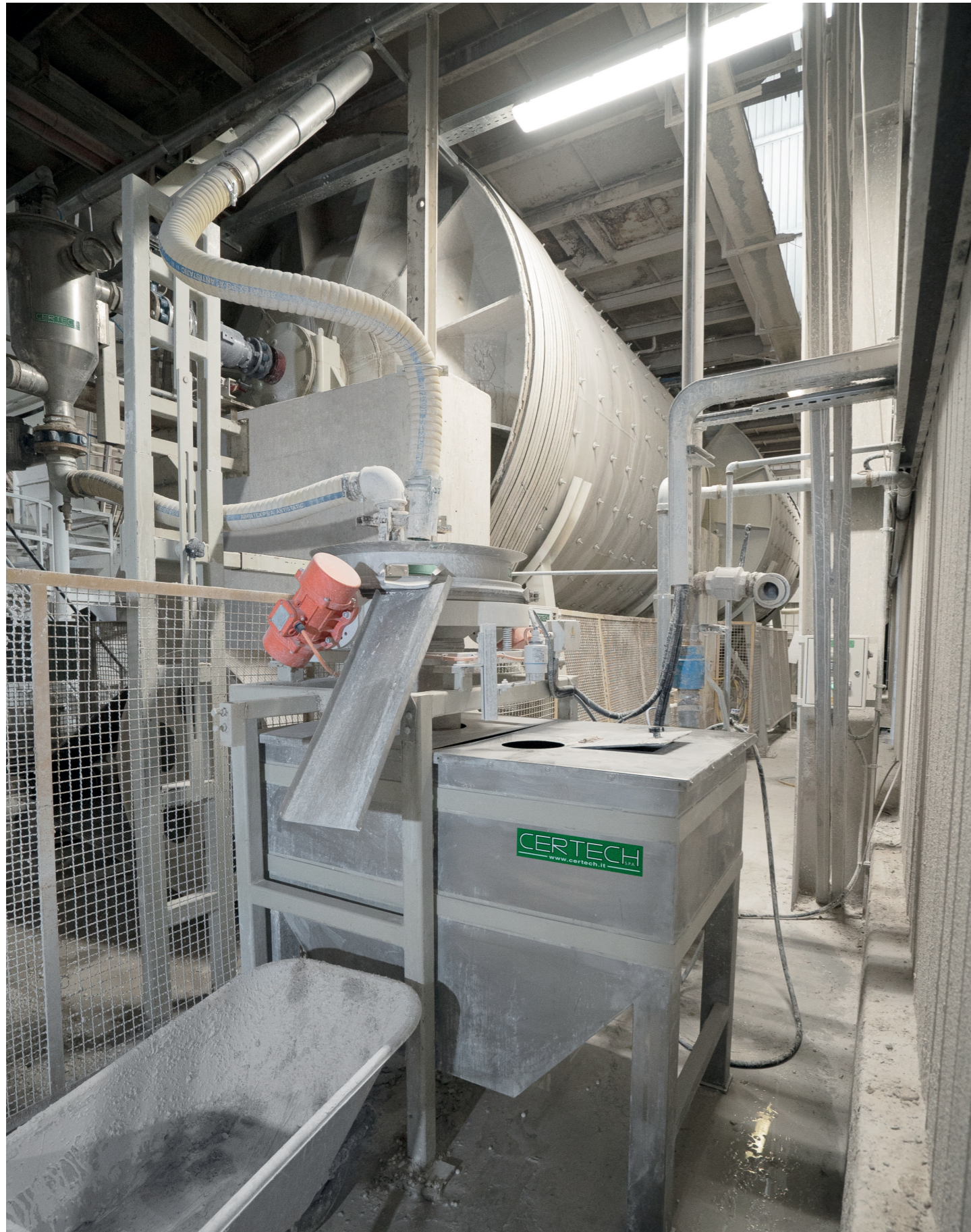
Zona di scarico terzo modulo. Unloading zone of the third module. Zona de descarga del tercer módulo. Zone de déchargement du troisième module. Área de descarga terceiro módulo.
