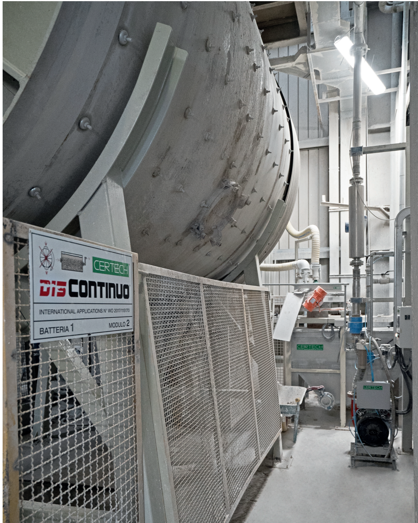
Secondo modulo con setaccio sghiaiatore, vasca e pompa centrifuga di trasferimento barbotina. Second module with sediment excluding sieve, tank and centrifugal pump for slip transfer. Segundo módulo con tamiz desarenador, tanque y bomba centrífuga de transferencia barbotina. Segundo module avec tamis dégraveur, cuve et pompe centrifuge de transfèremet barbotine. Segundo módulo com crivo para eliminar sedimentos, tanque e bomba centrífuga de transferência barbotina.
